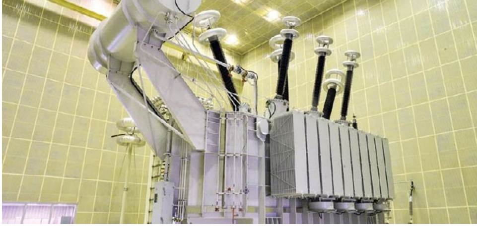
Şekil 64: Faz Kaydırma Transformatörü Örneği - Best Transformatör (Erdoğan, 2018)
